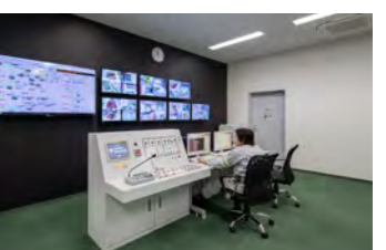
⑧ 中央制御室 施設内の機械の運転をコントロールしたり運転状況の監視をします。クレーン操作室もここに併設しています。
